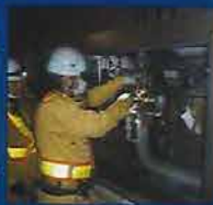
水噴霧装置点検
